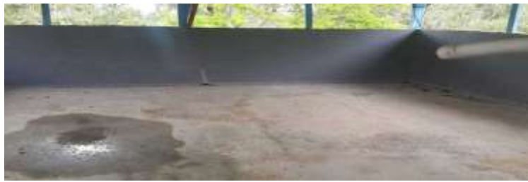
Gambar 1. Kondisi Tangki Air Pamsimas 2017 di Desa Sawang Selatan
